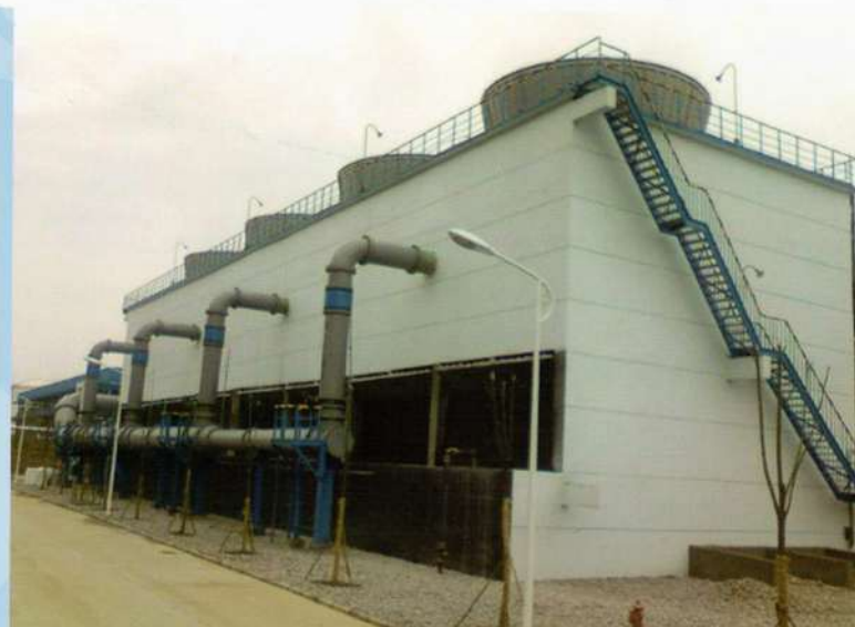
中海油湖北大峪口化工有限责任公司 CNOOC Hubei Dayukou Chemical Co., Ltd. 磷酸装置SHNW-2000×4型冷却塔
