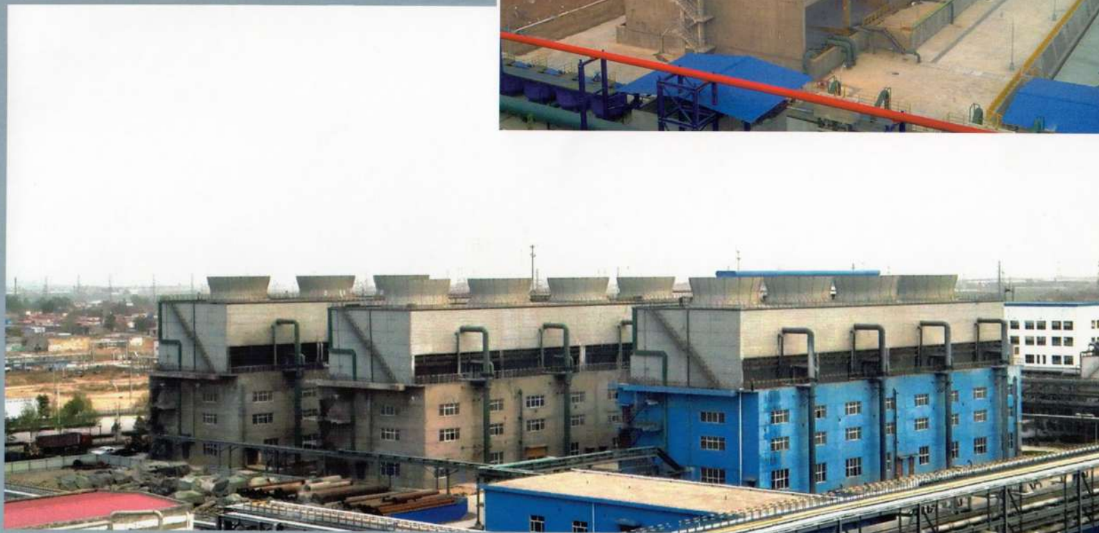
晋煤金石化工投资集团有限公司 Jincheng Anthracite Jinshi Chemical Industry Investment Group Co., Ltd. 制氮及硝铵工程16台SHN-5000型冷却塔
