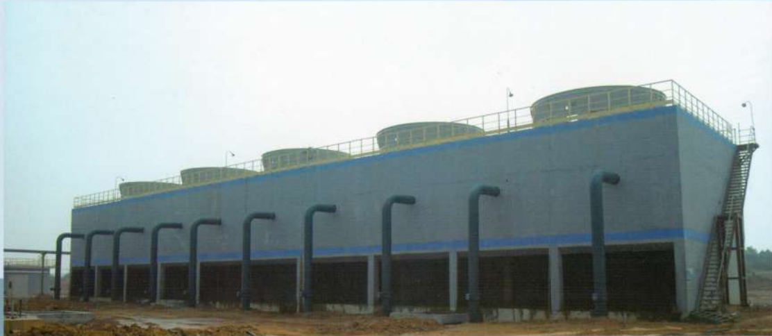
江西宏宇能源发展有限公司 Jiangxi Hongyu Energy Development Co., Ltd. 130万吨焦化项目SHN-2000×4型冷却塔
