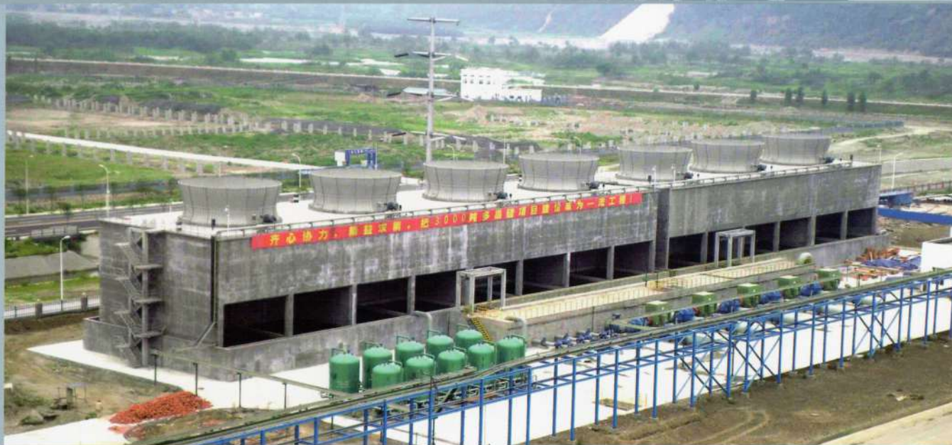
天威四川硅业有限责任公司 Tianwei Sichuan Silicon Industry Co., Ltd. 3000吨年多晶硅项目 7台SHN-4500型冷却塔
