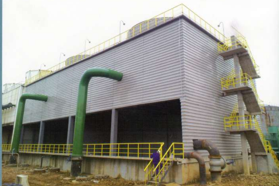
中石化九江分公司 SINOPEC Jiujiang Company 锅炉煤焦代油改造项目SHN-4000×2型冷却塔
