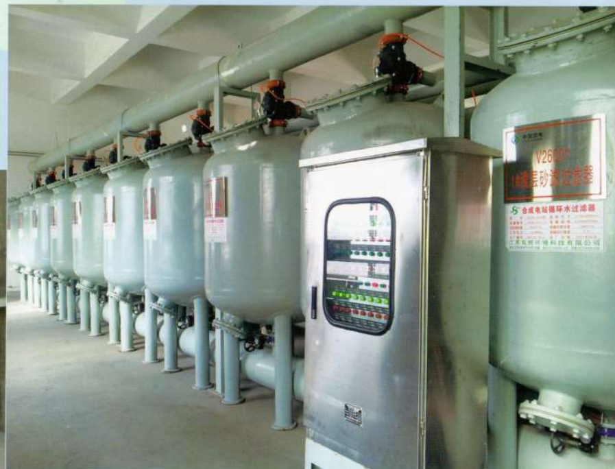
国电赤峰化工有限公司 Guodian Chifeng Chemical Co., Ltd. 56台SHGF-1200型浅层砂过滤器
