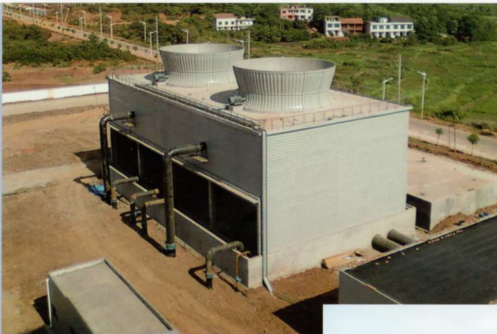
湖南理昂再生能源电力有限公司 Hunan Hengyang Li'ang Biomass Power Plants SHN-4500×2型冷却塔
