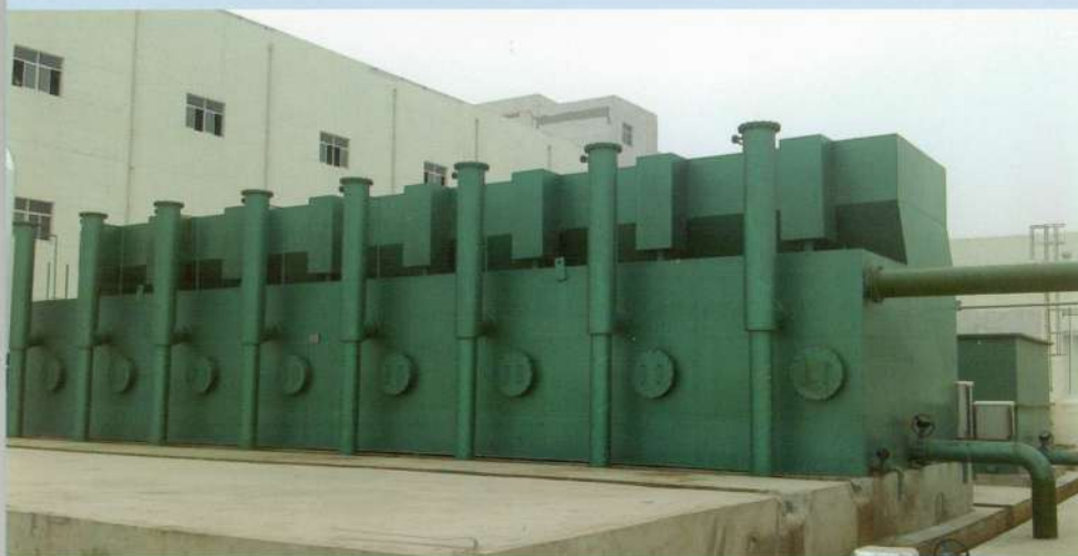
湘潭碱业有限公司联碱生产装置 Xiangtan Alkali Industry Co. Ltd. ZJS-II-250型一体化净水器
