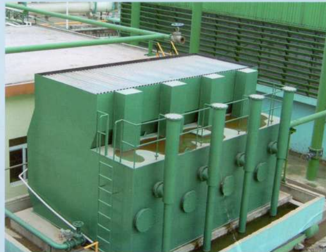
贵阳中化开磷化肥有限公司 Guiyang Sinochem Kailin Fertilizers Limited Company ZJS-II-100型一体化净水器
