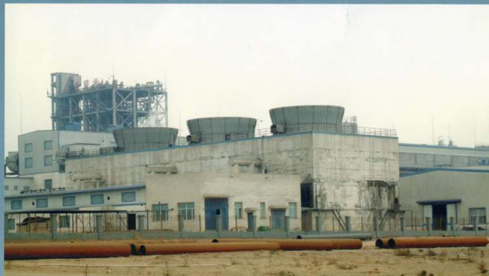
内蒙古锋威硅业有限公司 Inner Mongolia Fengwei New Energy Co., Ltd. SHN-5000×3型冷却塔
