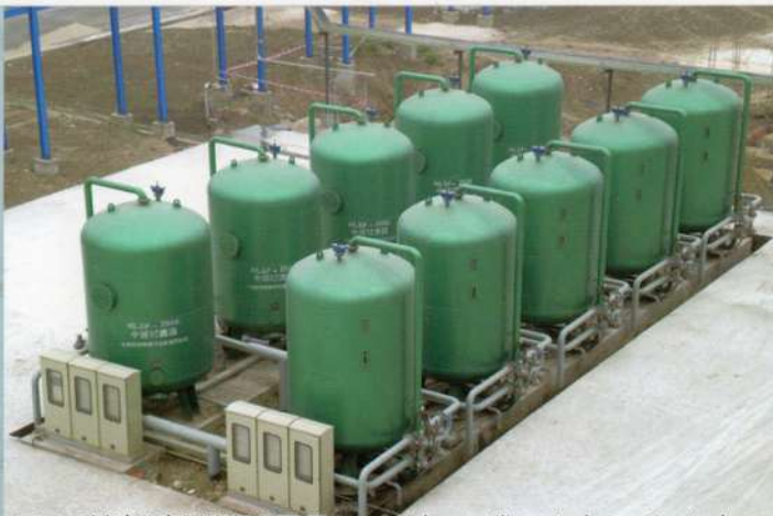
天威四川硅业有限责任公司 Tianwei Sichuan Silicon Industry Co., Ltd. 3000吨多晶硅项目10台HLSF-2800型中速过滤器
