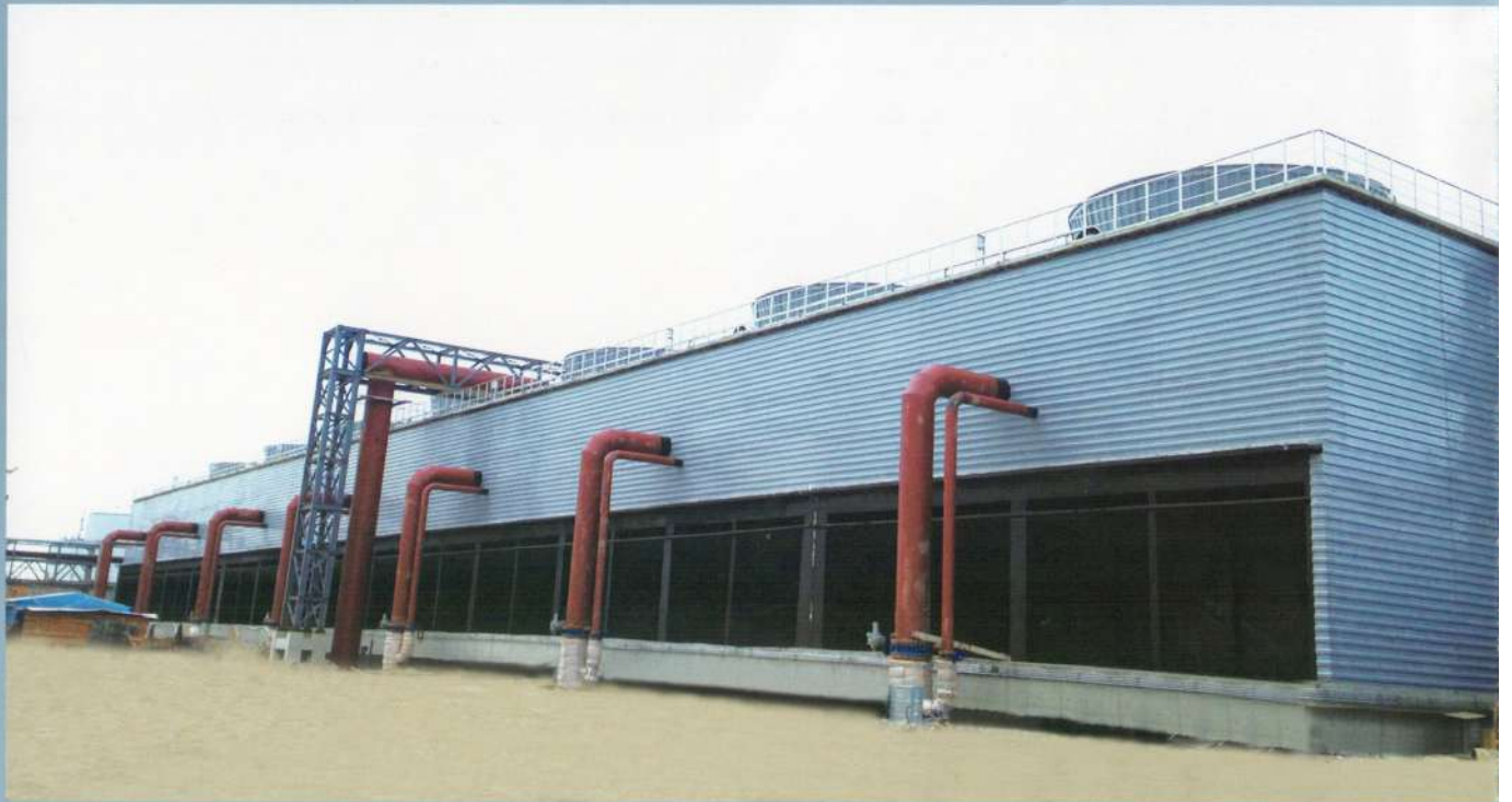
伊犁川宁生物技术有限公司 Yili Chuanning Biotech Co., Ltd. 万吨抗生素中间体二期工程 7台SHN-5500型冷却塔
