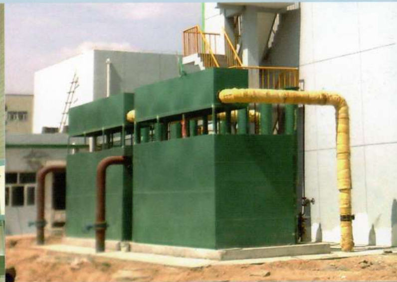
甘肃银达化工有限公司 Gansu Yinda Chemical Co., Ltd. 12万吨PVC项目方形无阀过滤器
