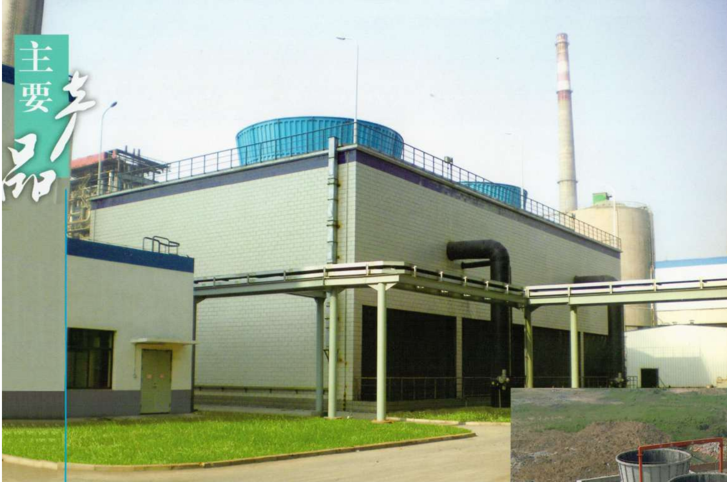
安徽山鹰纸业 Anhui Shanying Paper Industry Co., Ltd. 造纸污泥及浆渣焚烧发电工程 SHN-6000×2型冷却塔
