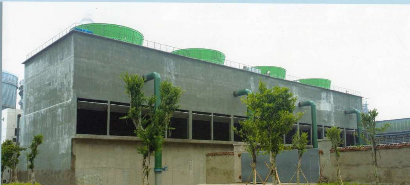
广西盛隆冶金 Guangxi Shenglong Metallurgical Co., Ltd 80MW高温超高压中间再热煤气发电工程SHN-4000×4型冷却塔
