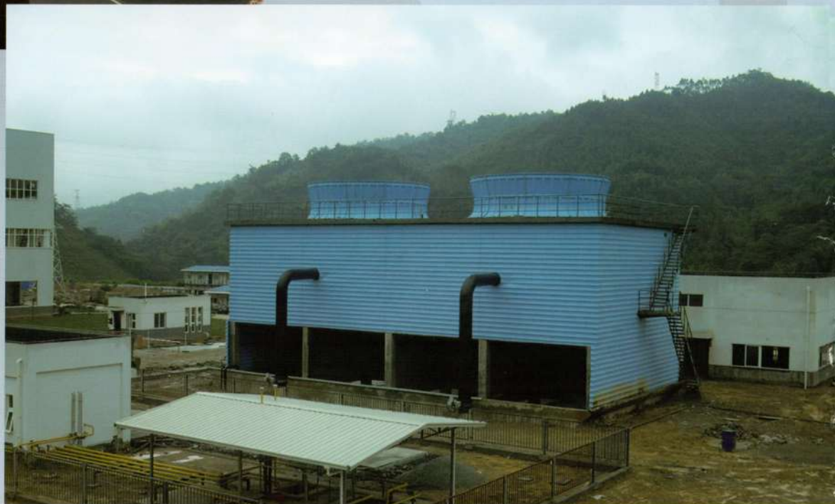
福建龙岩垃圾电厂 Longyan Xindongyang Environmental Purification Co., Ltd. SHN-2000×2型冷却塔
