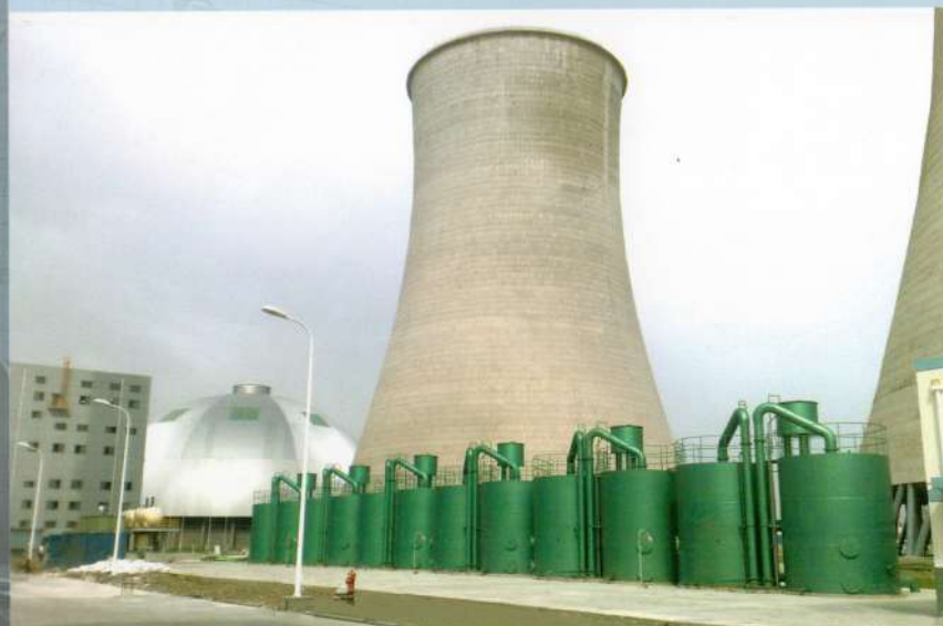
中石化镇海炼化分公司 Sinopec Zhenhai Refining & Chemical Company 6台OWLA-250型无阀滤池
